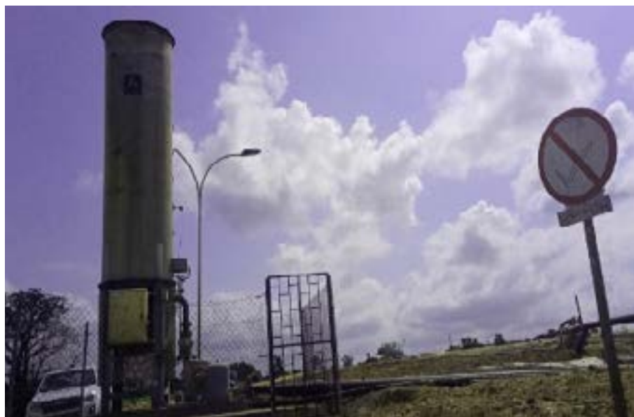
Une torchère installée au CET
