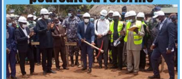
Le ministre Kokoroko donnant les premiers coups de pioches pour le démarrage des travaux.
