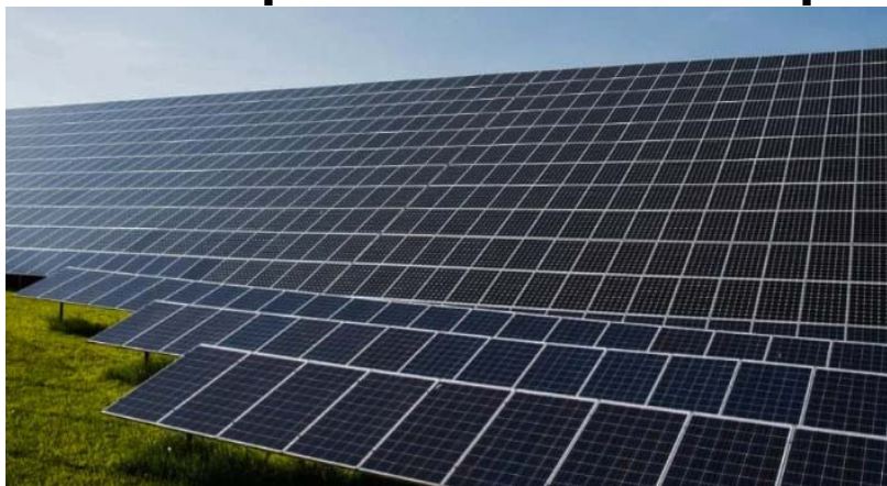
Des panneaux solaires
