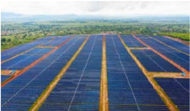
Une centrale solaire
