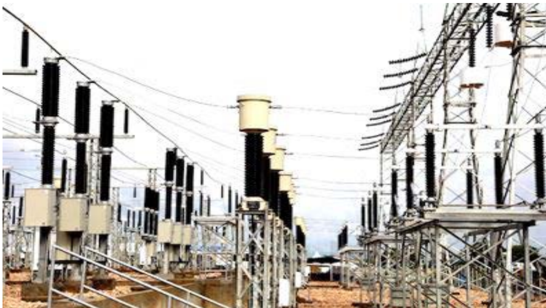
Centre solaire de Blitta
