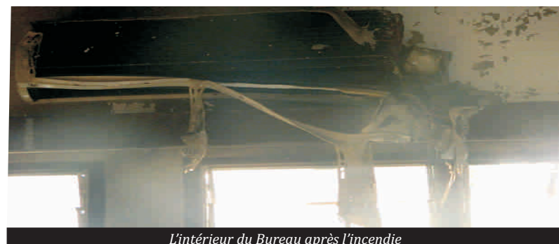
L'intérieur du Bureau après l'incendie
