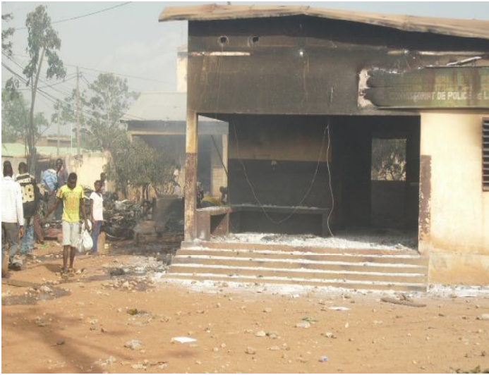
Le bâtiment du Commissariat de Police de Dapaong incendié
