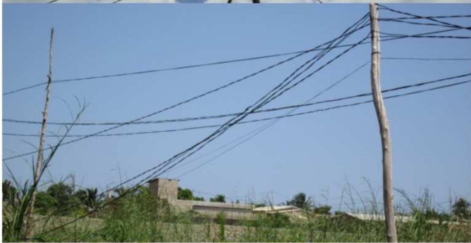
Des fils électriques anarchiquement installés qui parfois rasent même le sol et les habitations à Zopomahé
