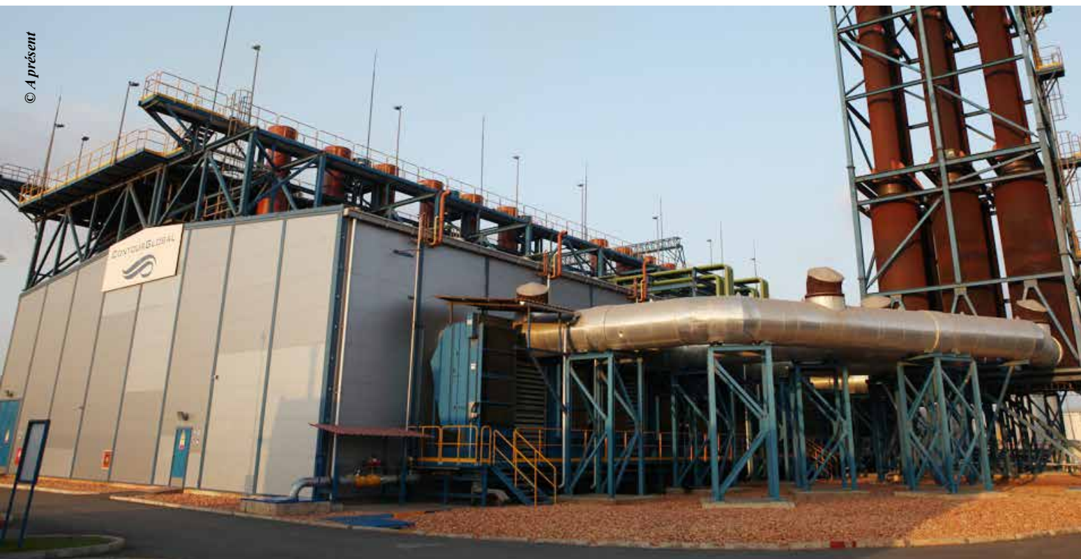
La centrale thermique de Lomé
