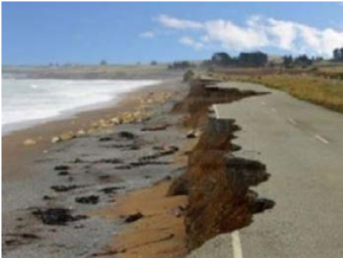
Une route endommagée par la mer
