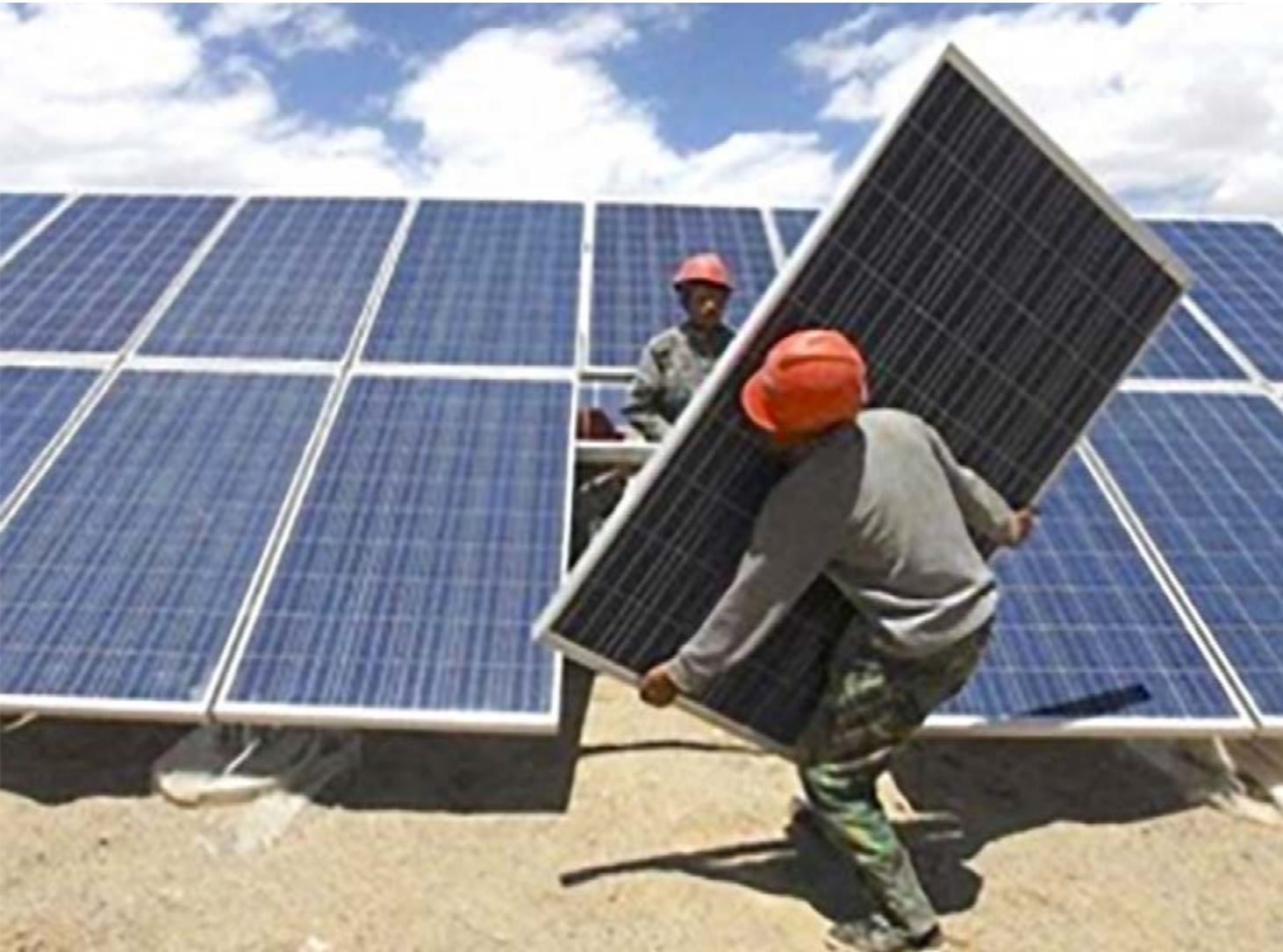
Une installation de panneaux solaires
