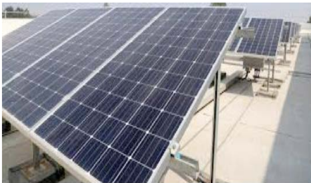
Des panneaux solaires
