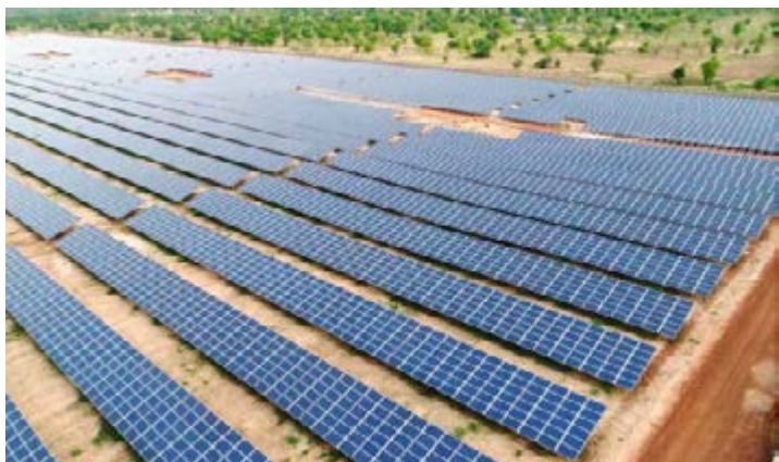
Une centrale solaire
