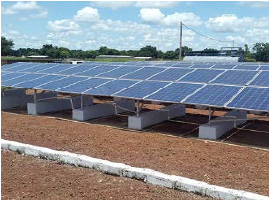
Des panneaux solaires
