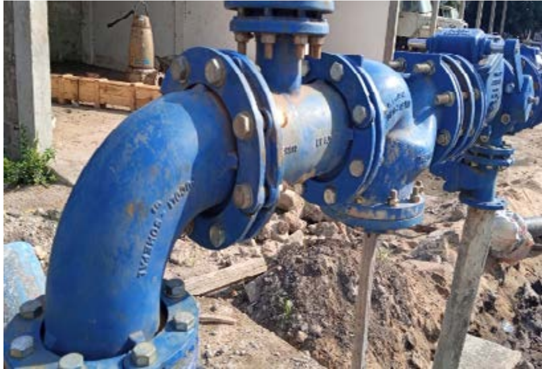
Aperçu d'un branchement
