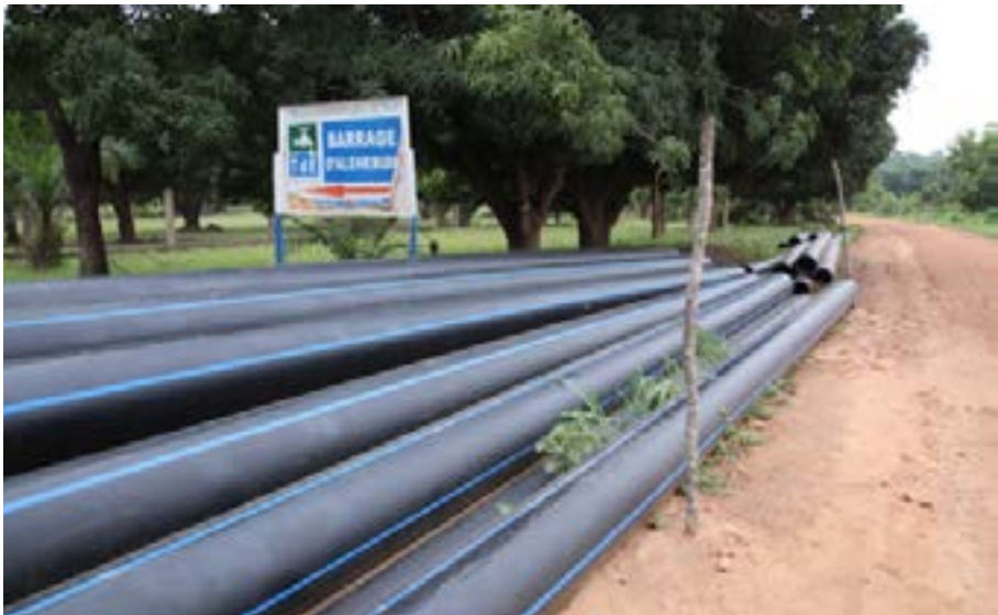
Tuyaux de canalisation pour une prise directe au barrage de Bolé
