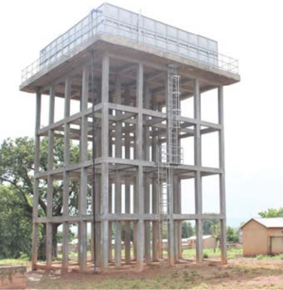
Château d'eau modulaire de Baga (Doufelgou)
